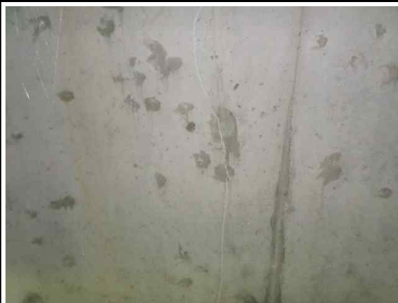
cw=0.3\text{mm} 이상 균열 (A2:김천방향)
