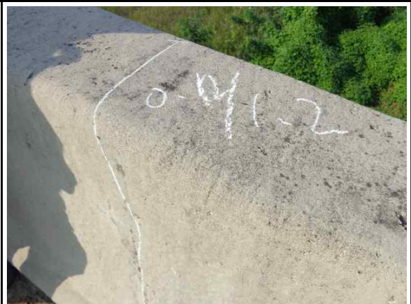
cw=0.3\text{mm} 미만 수직 균열 (S2:김천방향)
